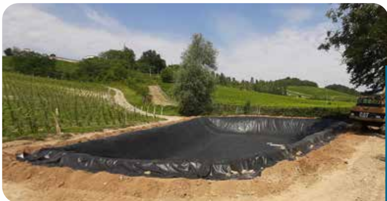
(Novi Ligure, Piemonte, 2019) Lago destinato allo stoccaggio di acqua irrigua per i vigneti retrostanti, scavato in terra e impermeabilizzato mediante una guaina in caucciù sintetico (gomma EPDM) resistente ai raggi UV, all'allungamento fino al 300% e alle basse temperature fino a -45°C.
