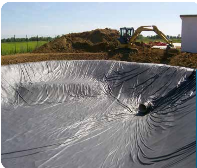
(Santhià, VC, 2009) Nella foto di questo lago per lo stoccaggio d'acqua antincendio è possibile notare il tubo di aspirazione delle pompe. Il lago ha una forma ovale e anche alcuni gradoni: ciò lascia intendere che sia possibile impermeabilizzare qualsiasi forma e dimensione. Le pieghe nei teli non causano alcun problema: il telo era stato saldato in fabbrica, in forma rettangolare, mentre gli attacchi per le tubazioni erano state realizzate in loco da ns. tecnici specializzati.
